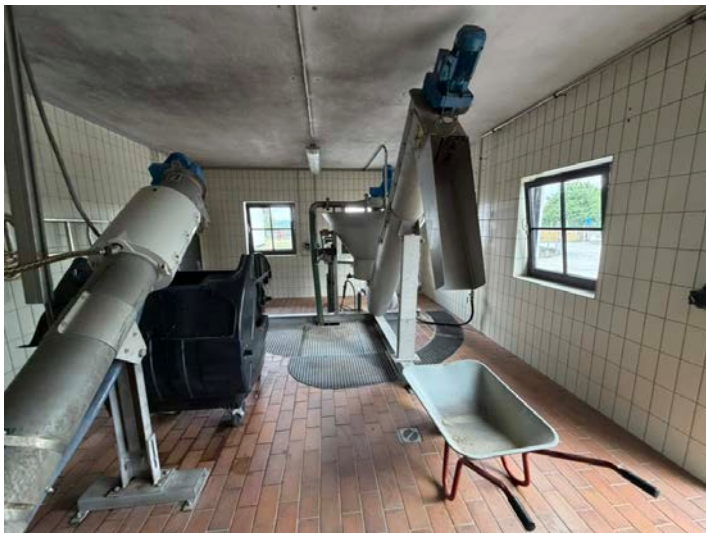
Abbildung 4: Rechen, Sandfang und -wäscher
