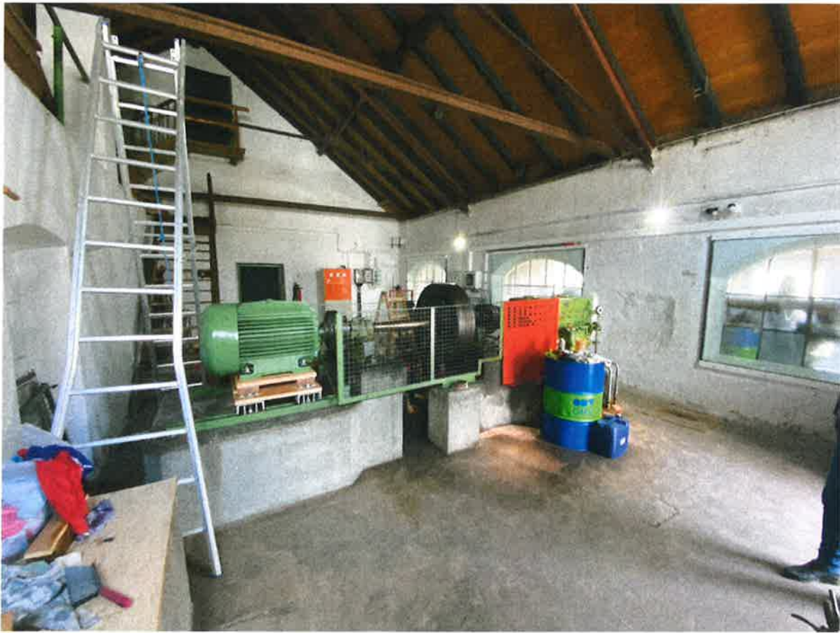
Bild Bestandsturbine mit Generator, IB Ederer 16.03.2023
