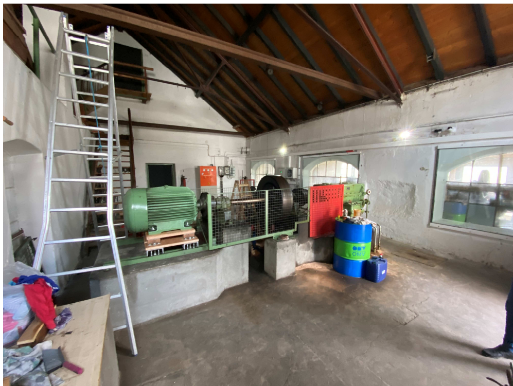
Bild Bestandsturbine mit Generator, IB Ederer 16.03.2023
